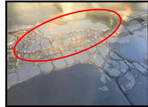
路面のひび割れなど
